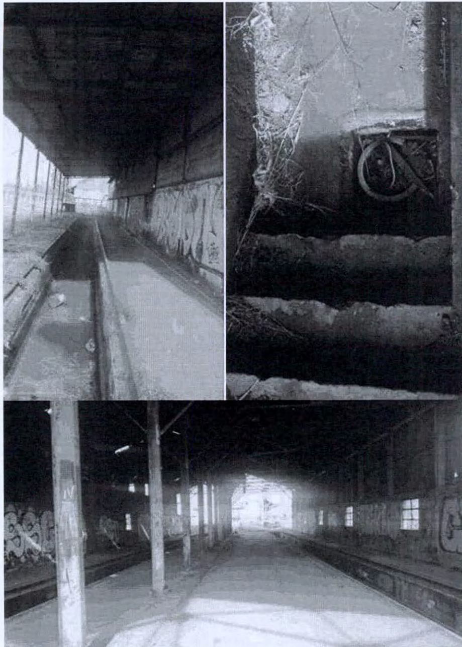
Ilustración 39: vistas de las fosas de mantenimiento de locomotoras y detalle de las cámaras colectoras de líquidos
